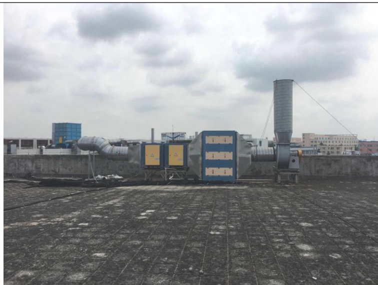
废气处理设施及排气筒
