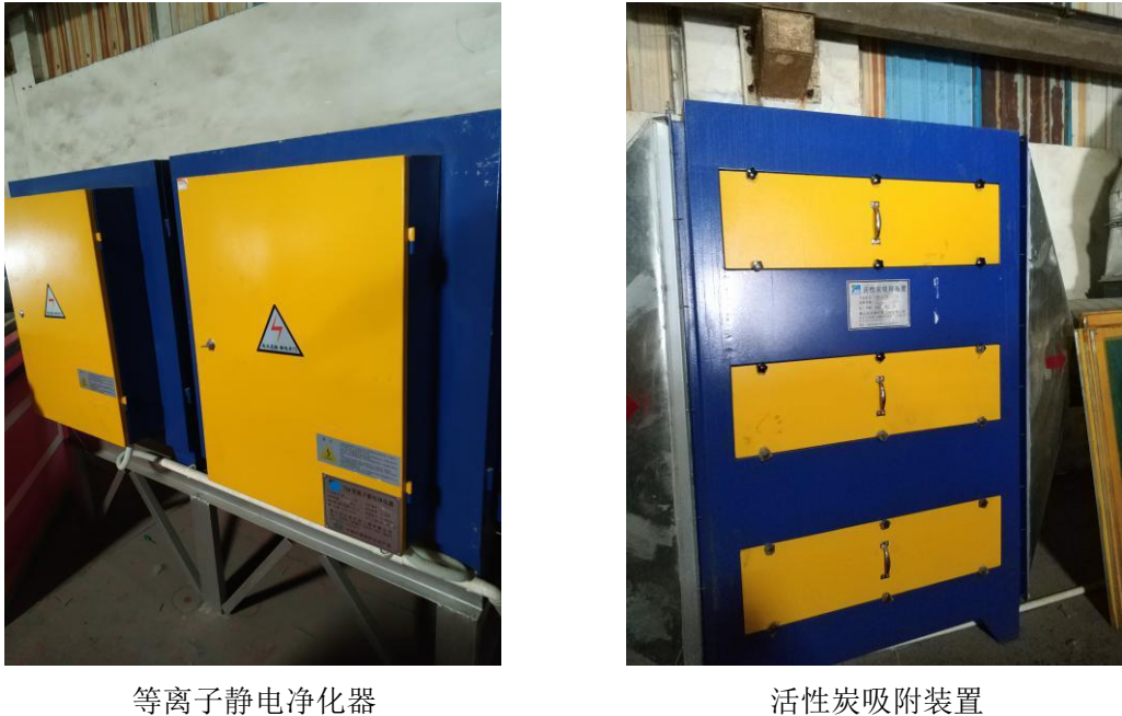
图 4.1.2-2 废气治理设备图
