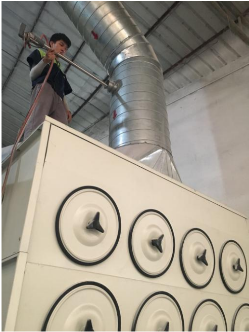
混料破碎粉尘处理前监测口
