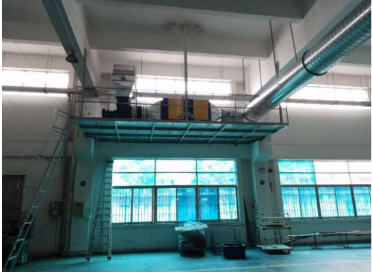
静电除尘处理装置
