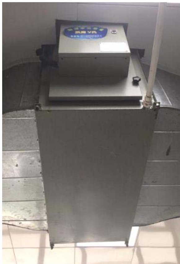
图4.1.2-2 废气治理设施图
