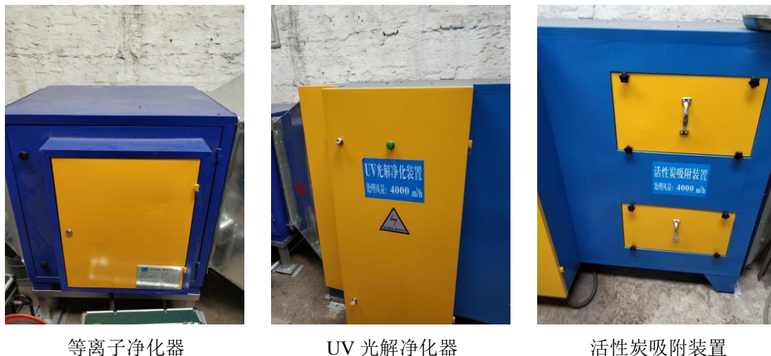
图 4.1.2-2 废气治理设施图
